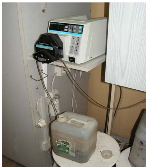
Fot. 4. Pompa dozująca (perystaltyczna) i zbiornik na ścieki
