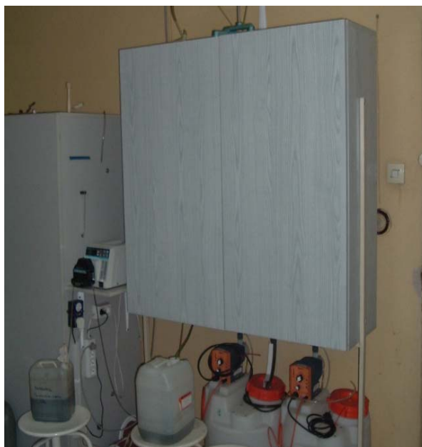
Fot. 3. Szafa termostatyczna ze złożem
