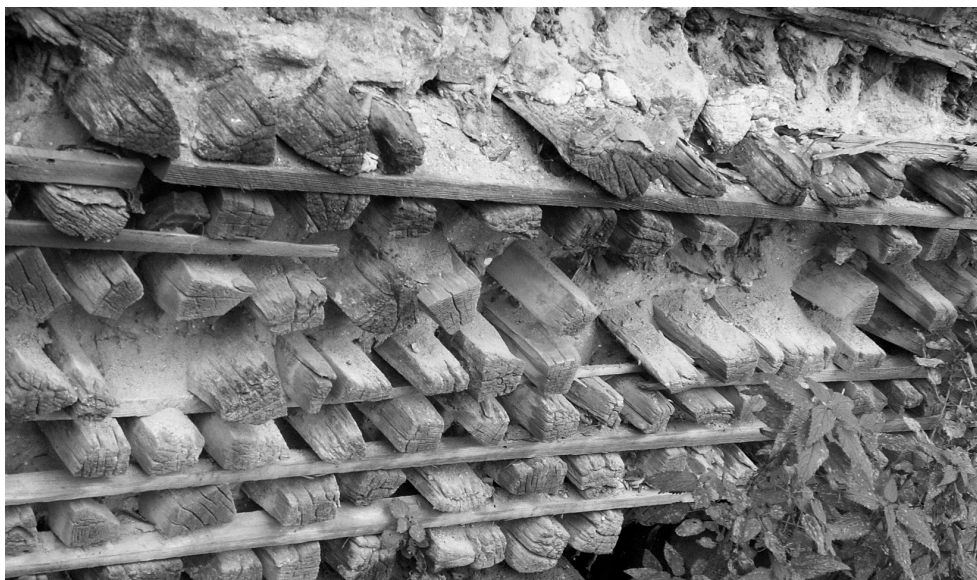
II. 2. Fragment ściany z polan opałowycy domu przy ul. Ostrowieckiej w Białymstoku, zbudowanego w latach 1926-27 roku, a zburzonego w roku 2007 (fot. J. Szewczyk, 2006)
