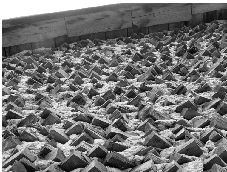
II. 5. Ściana z polan kładzionych skośnie na zaprawie wapiennej we wsi Mężenin koło Siemiatycz. wzniesiona w latach 60. XX wieku (fot. J. Szewczyk, 2008)
