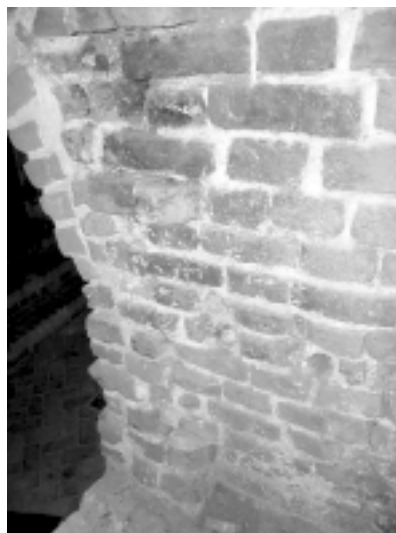
Ryc. 15. Okopczenia widoczne na powierzchni licowej zachodniej ściany komory wewnętrznej pieca. Fot. A.Bojęś-Białasik, 2009 Fig. 15. Soot black visible on the face of the west wall of the internal stove chamber. Photo by A. Bojęś-Białasik, 2009
