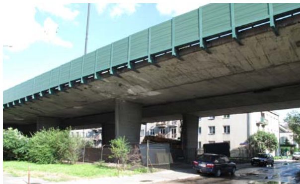
Rys. 10. Wiadukt nad ul. Paryską w ciągu Trasy Łazienkowskiej w Warszawie (B. Rymśza) Fig. 10. Viaduct over Paryska St. within the line of Łazienkowska Route in Warsaw
