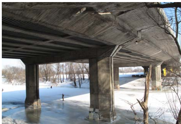
Rys. 5. Widok ogólny warszawskich „czterdziestek” w ciągu Trasy Łazienkowskiej w Warszawie Fig. 5. General view of Warsaw „forties” within the line of Łazienkowska Route in Warsaw
