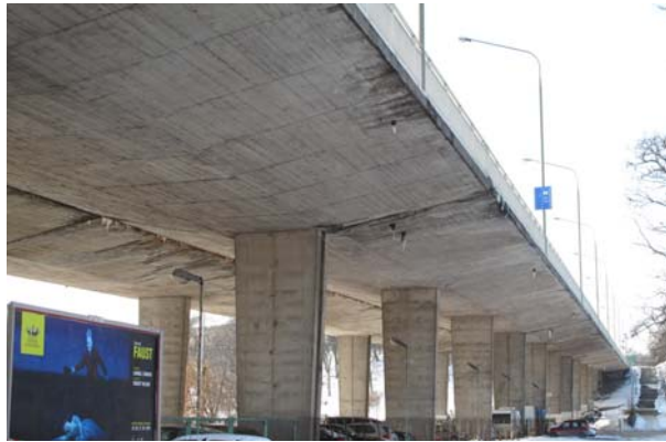
Rys. 9. Wiadukt nad parkiem Agrykola w ciągu Trasy Łazienkowskiej w Warszawie (B. Rymśza) Fig. 9. Viaduct over Agrykola Park within the line of Łazienkowska Route in Warsaw
